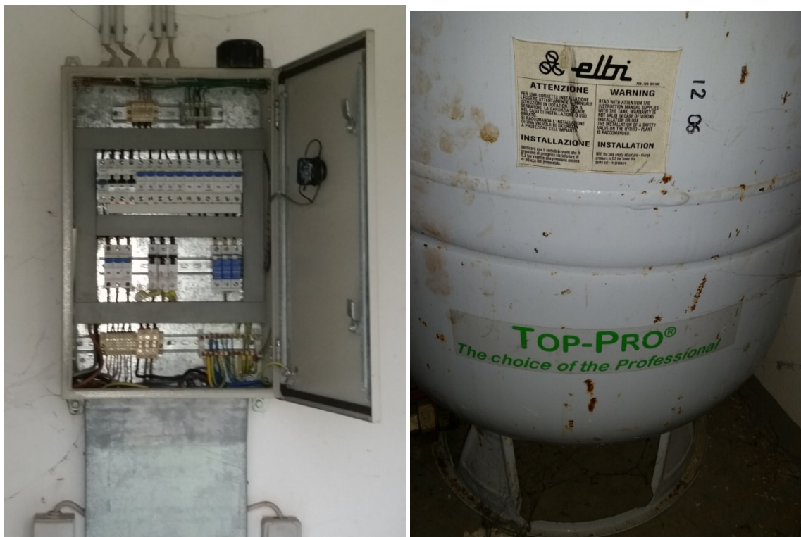
Slika 60. Izgled elektromara i tlačnog spremnika u objektu zdenca
