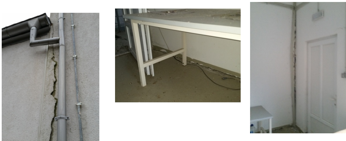
Slika 18. Uzdužne i pukotine na spoju dilatacije
