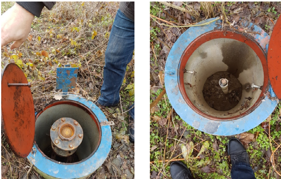
Slika 51. Izgled okna hidranta za navodnjavanje (Tip A i Tip C)
