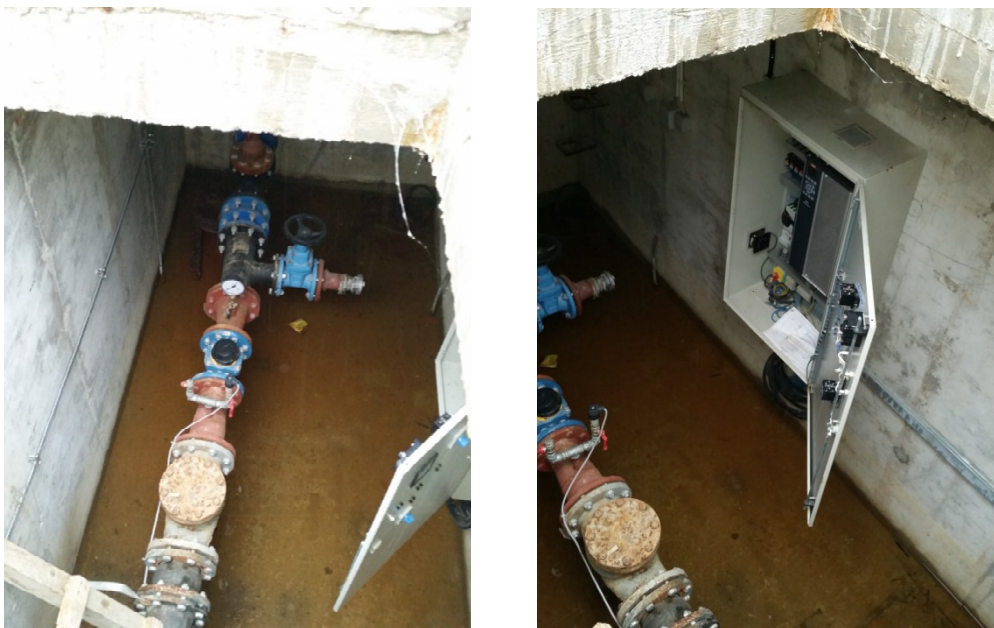
Slika 57. Izgled zasunske komore objekta zdenca
