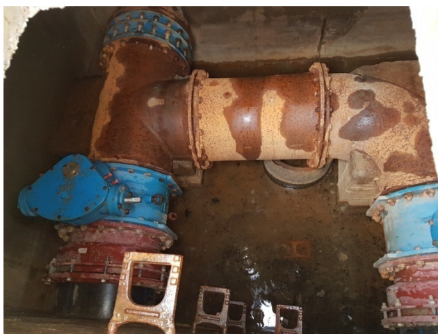
Slika 45. Izgled zasunskih okana tlačnog cjevovoda vezanog za zahvat vode iz rijeke Drave
