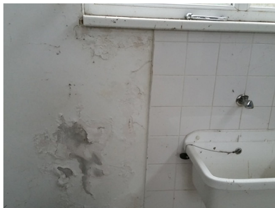
Slika 14. Oštećenja od vlage
