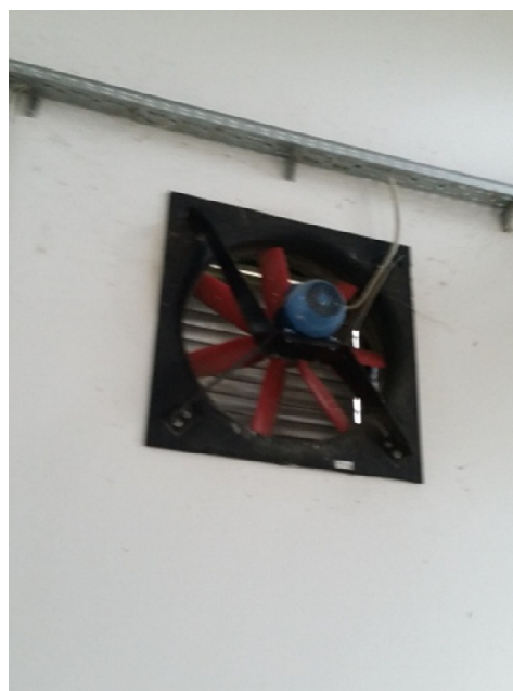
Slika 12. Izgled postojećih uređaja - ventilacija
