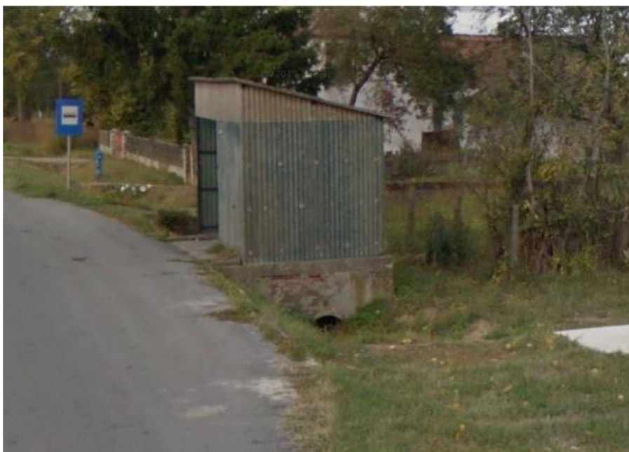
Slika 23. Prikaz neprimjerenog uređenja autobusnog stajališta
